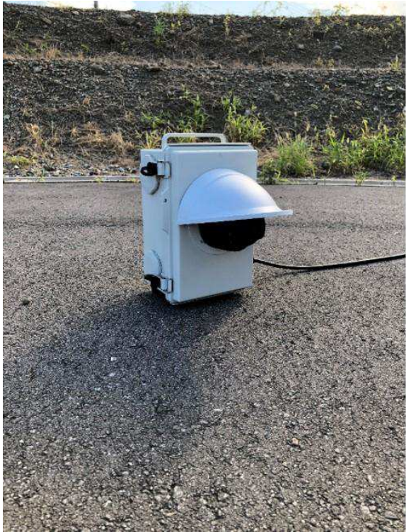
据置設置事例
